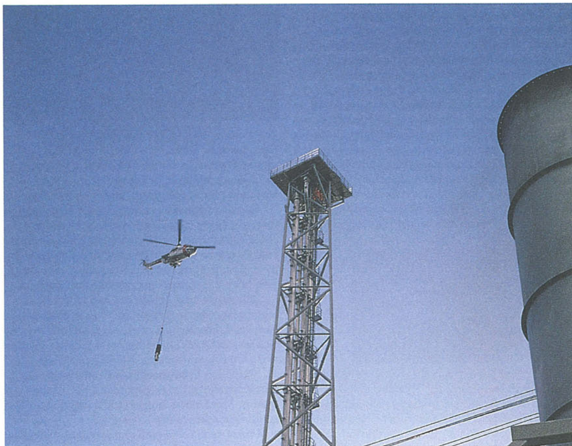
FAKKEL FJERNES: Gjennom installering av nytt utstyr er det ikke lenger nødvendig med kontinuerlig fakling på Heidrunfeltet.
