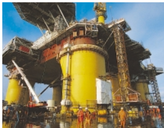
ÅSGARD B UNDER UTRUSTNING I STAVANGER.
