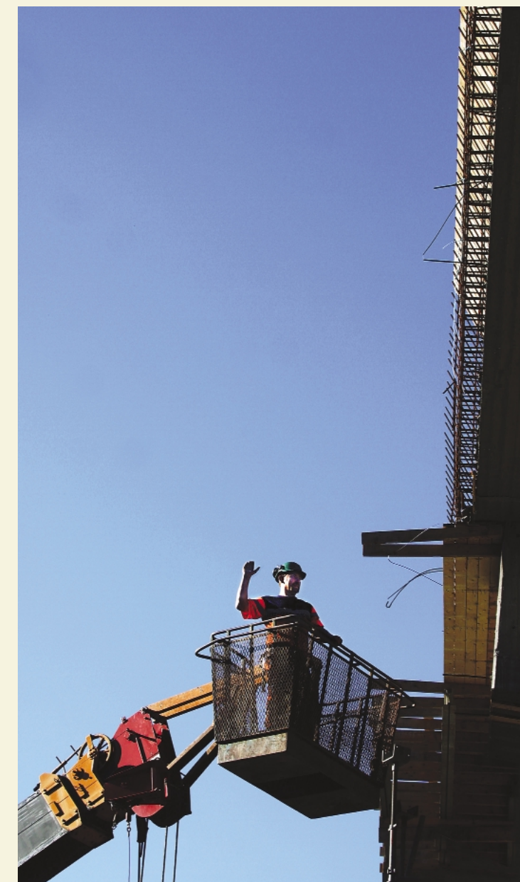
Mesta utfører alle typer anleggsoppdrag – fra små og enkle oppgaver, til store, omfattende og teknisk kompliserte løsninger.
