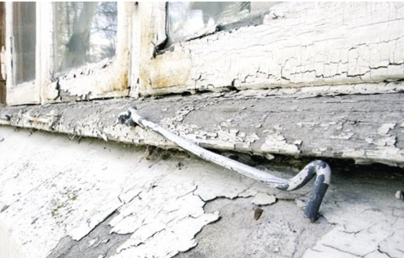
Bygningar og tekniske anlegg ved UMB har eit formidabelt etterslep i vedlikehaldet.
