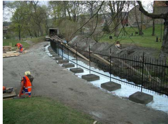
Ferdig oppsatt gjerde hvor det er isolert under. Gjerdet fundamenteres grunt på grunn av antikvariske hensyn. Det er uberørte kulturlag i grunnen under.
