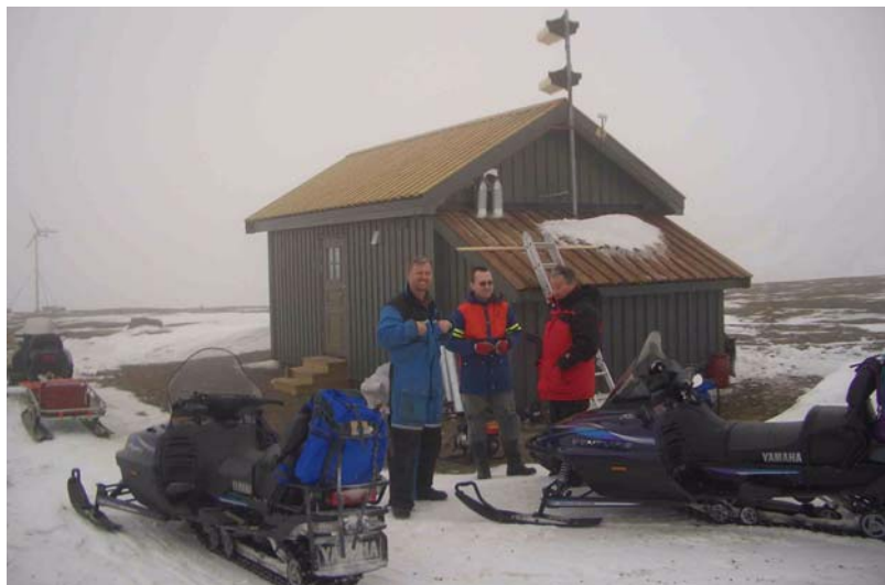
Bildet viser det nye sentralbygget ved den seismiske stasjonen på Spitsbergen, og er tatt i april 2004 under arbeid med installasjon av et nytt strømaggregat.
