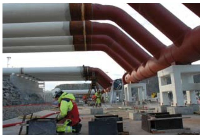
Mottaksanlegget for gass fra Ormen Lange i Nyhamna, kan få betydning for videreutvikling av Norskehavet.
