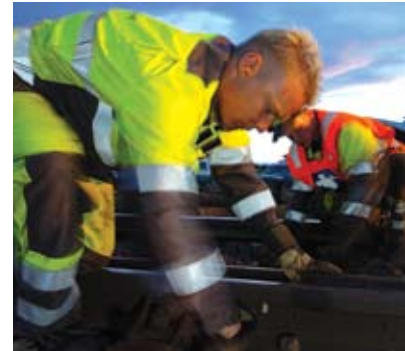
Banemontør Arild Kvaal i arbeid med sporveksel. Sikkerhetsmann Vegard Lade i bakgrunnen. Foto: Øystein Grue
