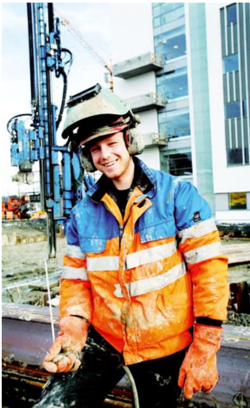
1200 mann i sving hver dag. Sveiser Tom Runar Hanes er en av de mange som arbeider for å få det nye sykehuset ferdig.
