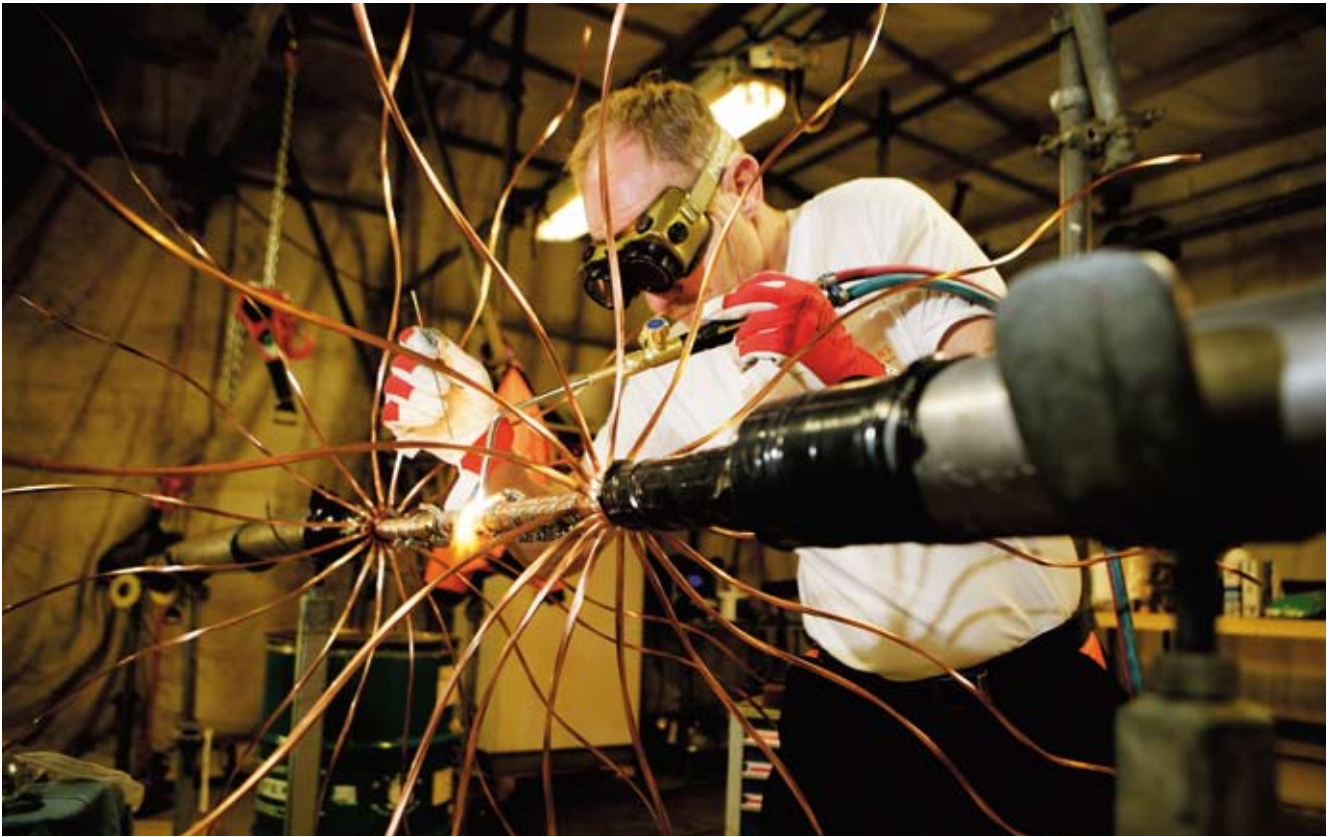
De åtte lengdene med kabel som NorNed består av er skjøtet sammen. Syv av skjøtene er foretatt til havs under tidvis svært krevende værforhold. I tillegg er det foretatt skjøter, som på bildet, for å knytte kabelen til landanleggene.
