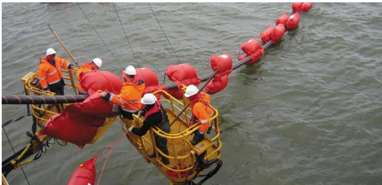
NorNed består av totalt åtte kabellengder. Første lengde ble lagt utenfor Eemshaven nord i Nederland våren 2006.
