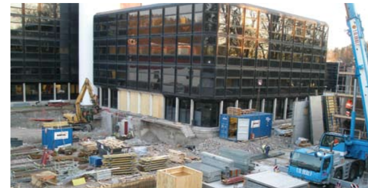
Asker og Bærum politidistrikt får nytt politihus i 2009. Her fra byggeplassen på Kjørbo.
