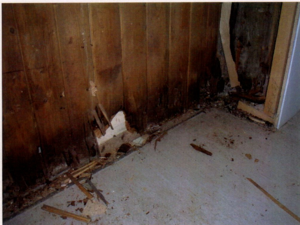
Råteskader i yttervegg, kontor i Artilleribygningen
