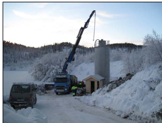
Figur. 5.2 Fra arbeidet med kalkdoseringsanlegget Fagerlivann.
