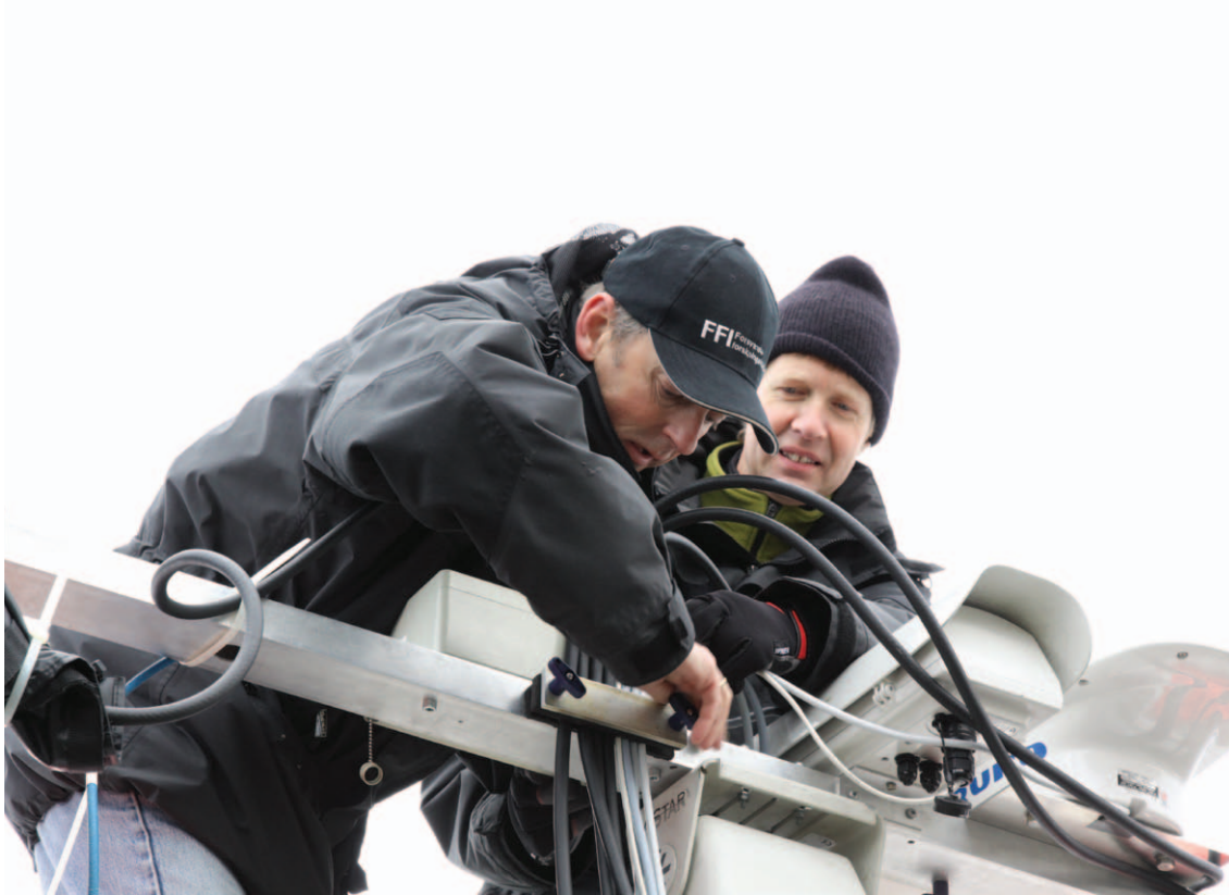
Høyteknologi i praksis. Senioringeniør Trond Haldor Hellum og forsker Øyvind Thingsrud fra avdeling Ledelsessystemer monterer antenneutstyr i forbindelse med et feltforsøk.
