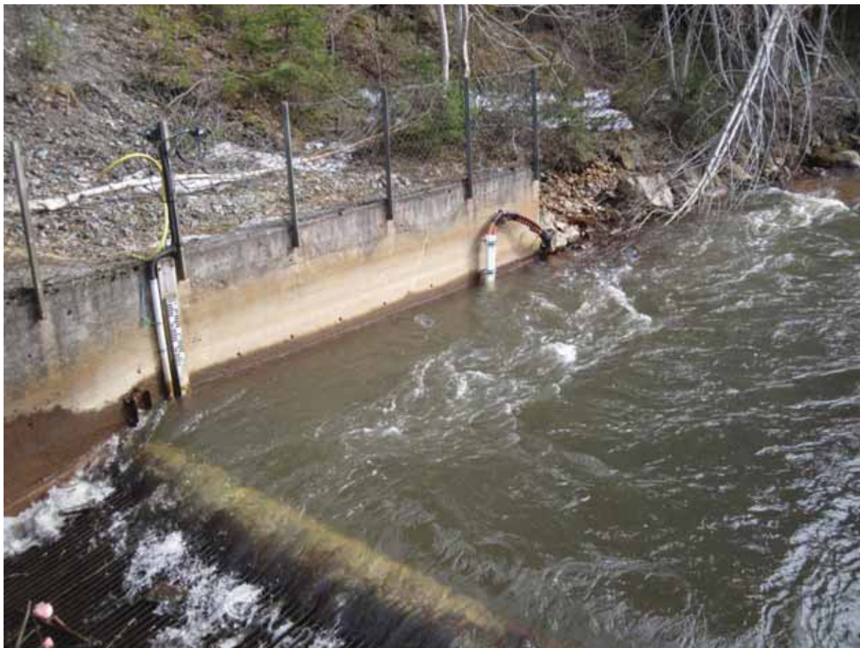
Målepunkt inntak Raubekken, Løkken
