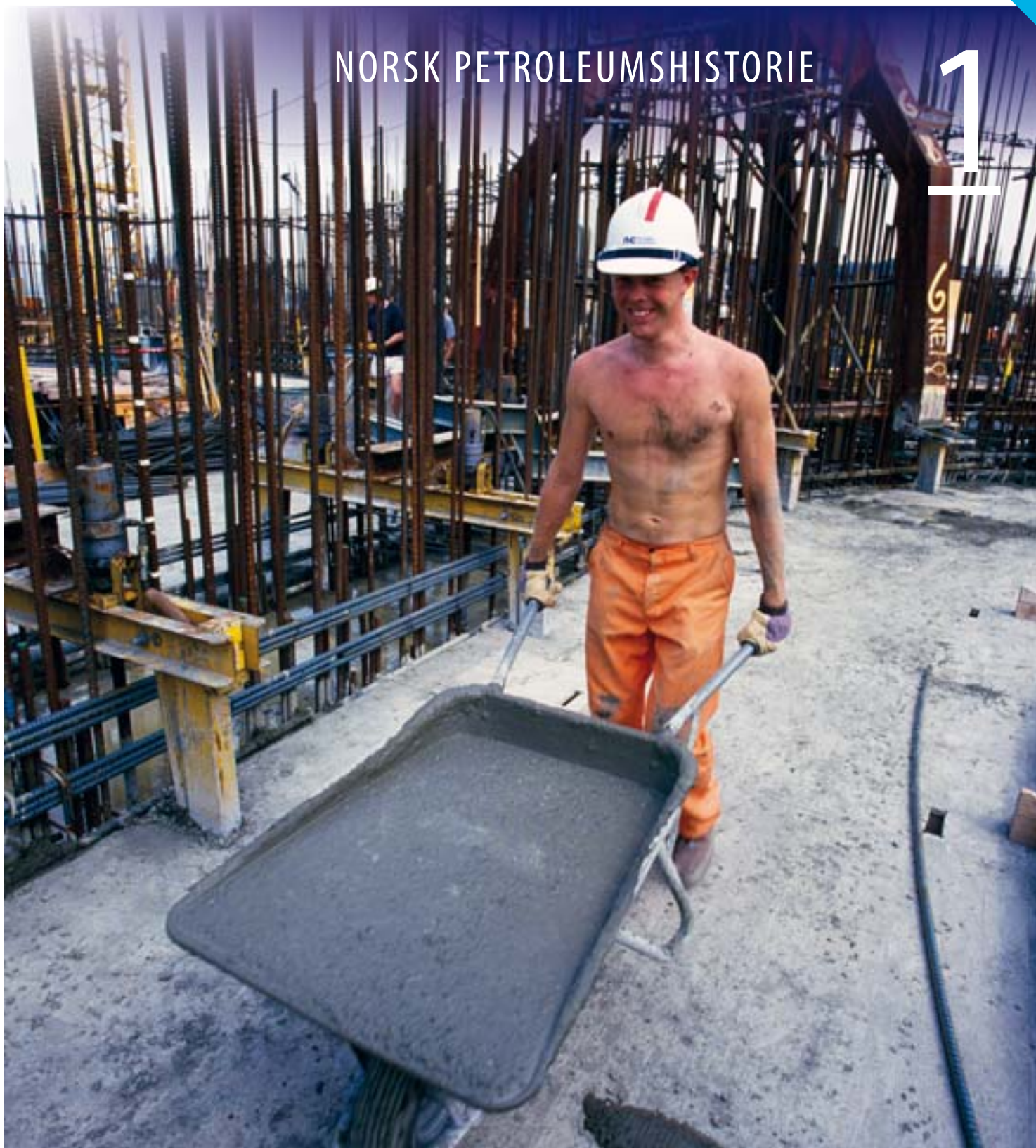
Hardt fysisk arbeid under støyping av understell til dei store betongplattformene på 1980-talet. (Foto: Leif Berge, Statoil)
