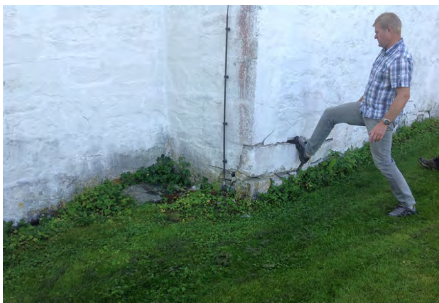
Kirkeverge Trond Haugen inspiserer skadene på middelalderkirken i Sauherad. Endrede grunnforhold og klima er mulige årsaker til at den har fått alvorlige sprekker i muren. For små kommuner med relativt små budsjett, blir det et problem å håndtere slike vedlikeholdskostnader. (Foto: G. Myre)
