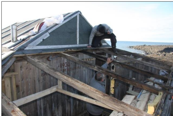
Arbeid med skifte av tak på Kapp Koburg på Kongsøya. Bilete: Hans Olav Stegarud/Sysselmannen på Svalbard
