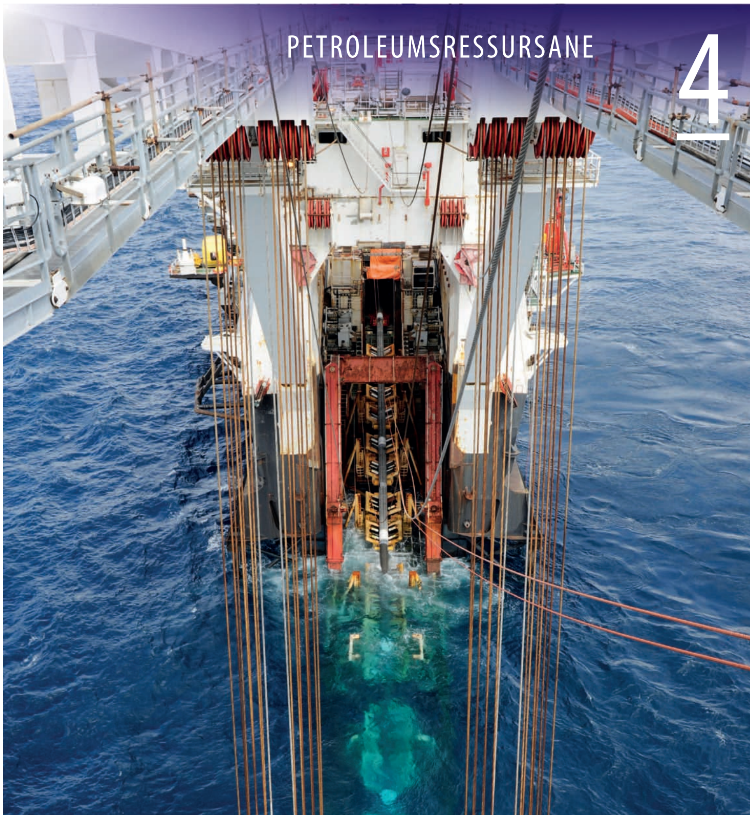
Rørleggjing på Ekofiskfeltet, det første feltet på norsk sokkel. Feltet kjem truleg til å produsere i 40 nye år. (Foto: Kjetil Alsvik, ConocoPhillips)
