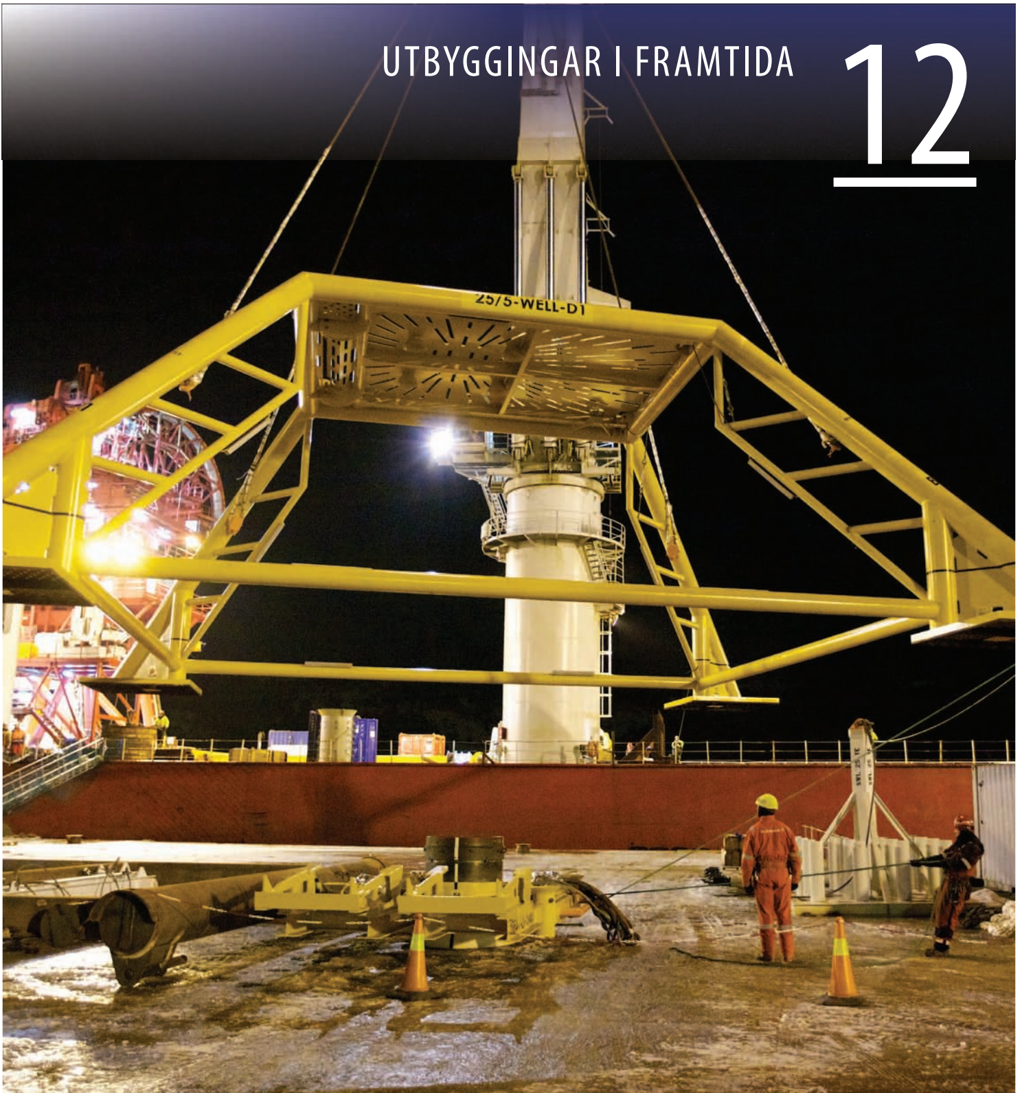
Svært mange felt blir bygt ut med undervassinnretninger. Denne står nå på havbotnen på Atlafeltet, der produksjonen starta i 2012. (Foto: Total, Woldcam)
