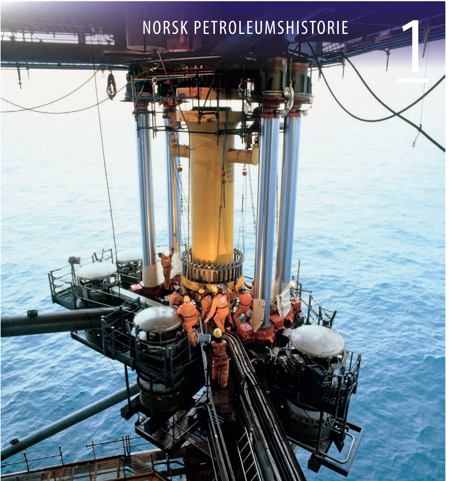
Frå oppjekking av Ekofiskinnretningane i 1987. Her blir det sett på eit stykke som forlengjer det eine beinet på hotellinnretninga Ekofisk 2/4. (Foto: Husmo, ConocoPhillips/Norsk Oljemuseum)
