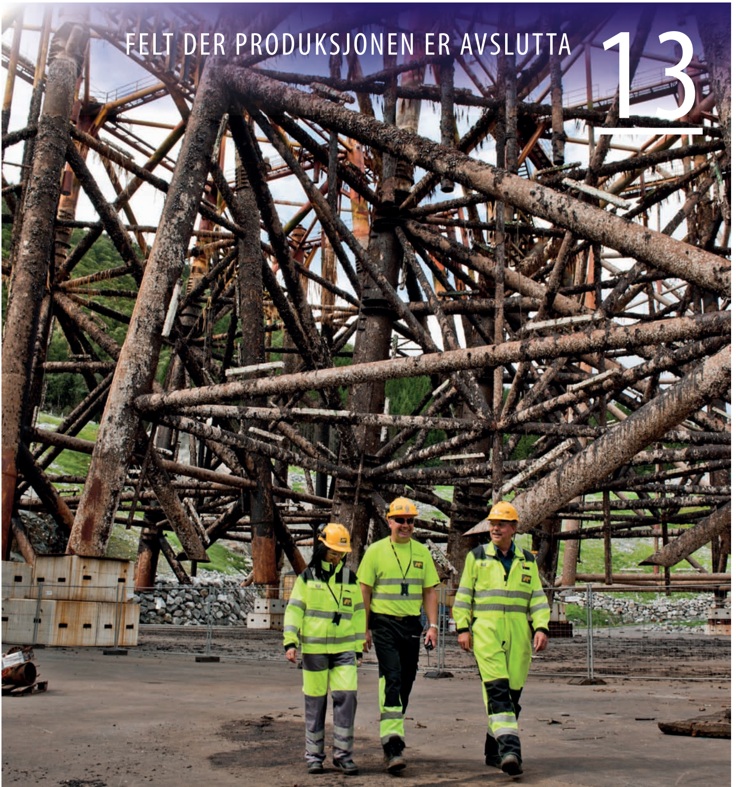
Norsk sokkel er blitt moden, og dei første innretningane er fjerna og hogd opp på land. (Foto: Monika Larsen, Oljedirektoratet)
