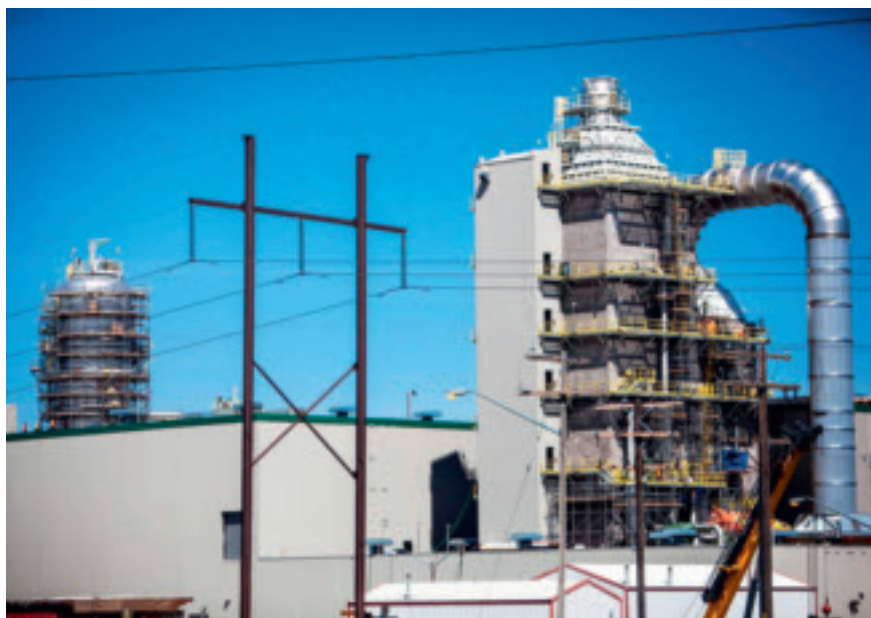
Boundary Dam CCS i Alberta i Canada er verdens første fullskala CCS-anlegg for fangst av CO 2 fra røykgass fra kraftverk. Til venstre er CO 2 -stripperen, og til høyre vises anlegget som skal rensa svoveldioksid. Foto: Håkon Jacobsen
