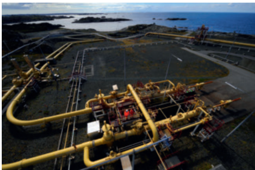
På Kalsto i Rogaland kommer rikgassen i land fra norsk sokkel på vei til prosessanlegget på Kårsto og videre eksport til Europa. Foto: Øyvind Setre, Gassco.
