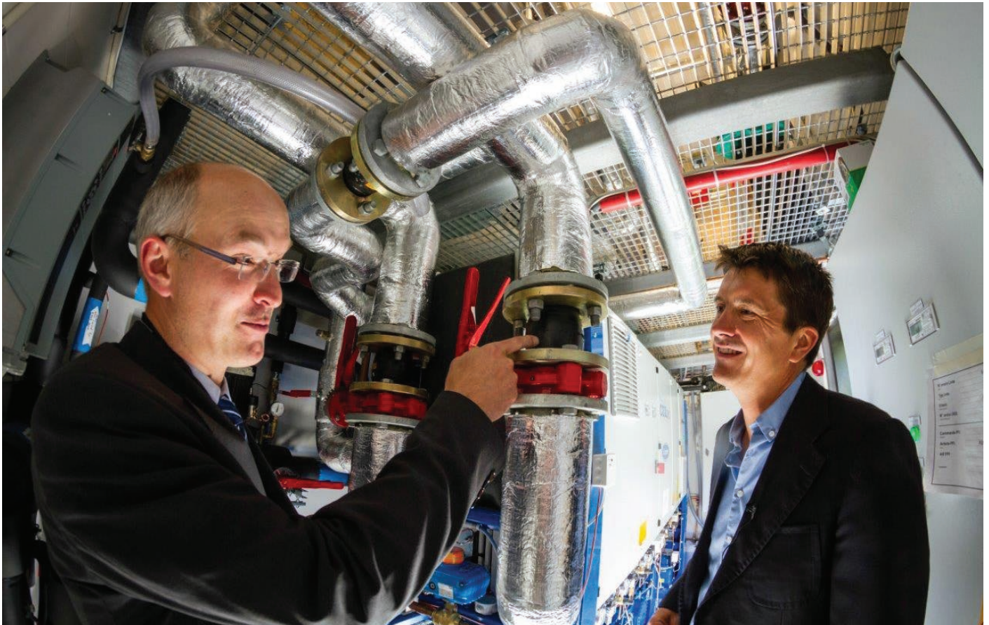
Seniorforsker Armin Hafner og Rema-sjef Ole Robert Reitan i maskinrommet for butikkjøling. Smart bruk av dagslys og spillvarme har gitt en energigjerrig dagligvarebutikk. Foto: SINTEF/Thor Nielsen
