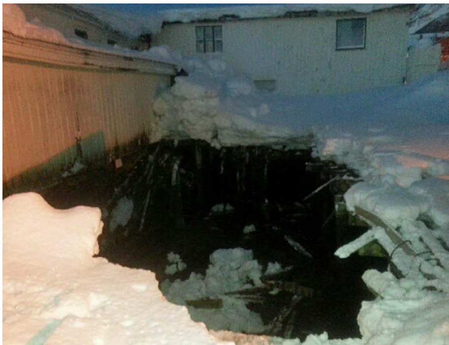
Bilde 4. Kollapset kai som førte til utslipp av 180 m 3 diesel i Skjervøy
