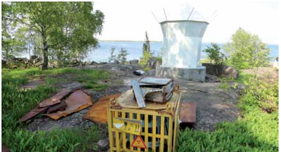
En radioaktiv kilde er fjernet fra en fyrlykt i Østersjøen. Foto: Per-Einar Fiskebeck, Fylkesmannen i Finnmark.
