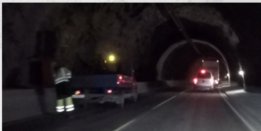
Onstatunnelen: Bildet viser pågående arbeid uten markering eller sikring av arbeidsområdet. Tunnelen var på dette tidspunktet kolonnekjørt.
