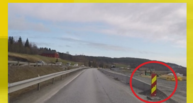
Langsgående rekkverk utan arbeidsrom. Dette er ikkje i samsvar med Handbok N301.
