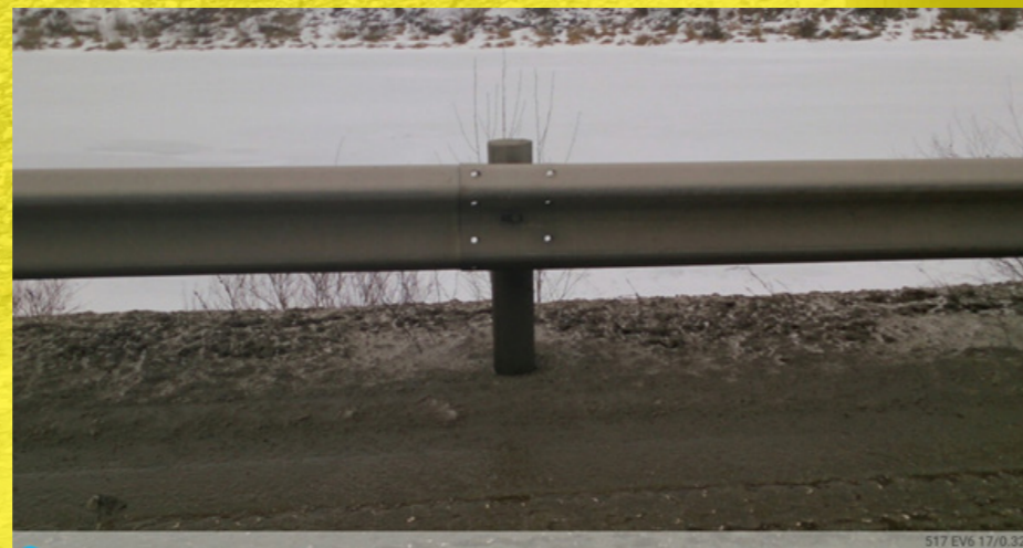
E6 Sel, Gudbrandsdalsvegen. Alle boltene mangler i rekkverket.
