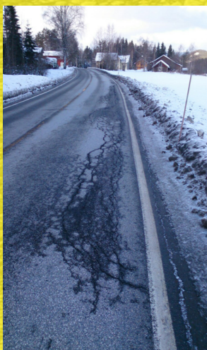
Rv 3 Stor Elvdal. Omfattende krakelering av vegdekke, setninger i hjulspor.
