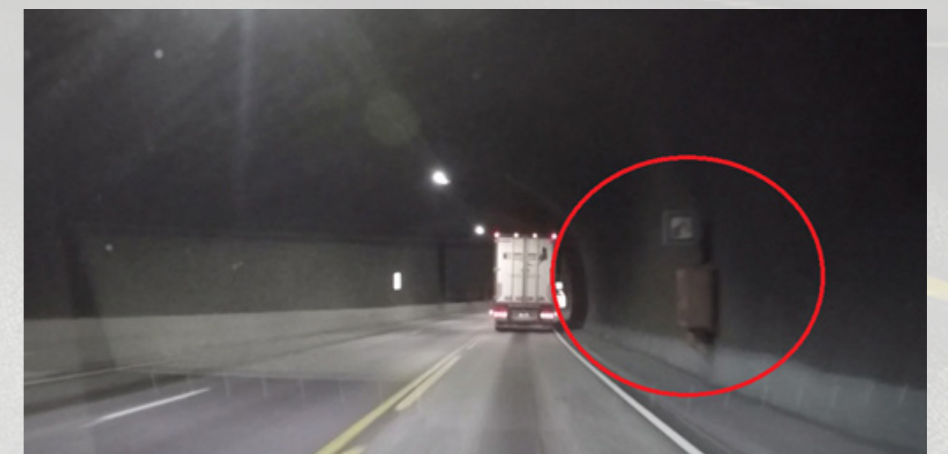
Bømlafjordtunnelen: Manglende lys i skilt over nødskap. Det er usikkert om nødskapet er i drift eller ikke. Ifølge beredskapsplan skal nødutstyr være i drift gjennom hele anleggsperioden.
