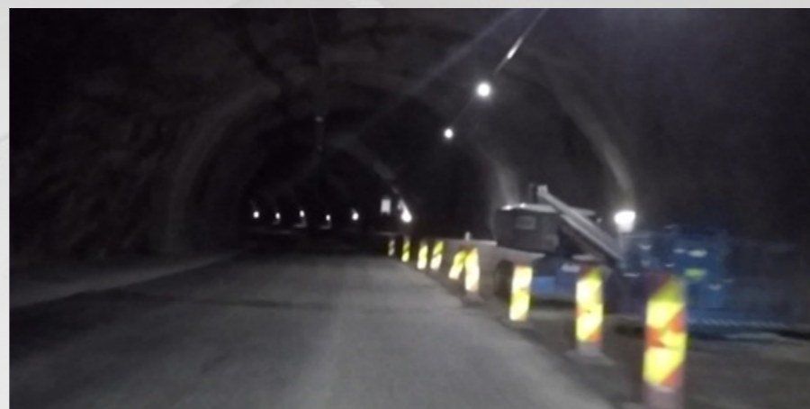
Freheimstunnelen: Lift parkert tett inntil vegkanten. Fare for påkjørsel, ingen sikring. Fartsgrensen er 60 km/t.
