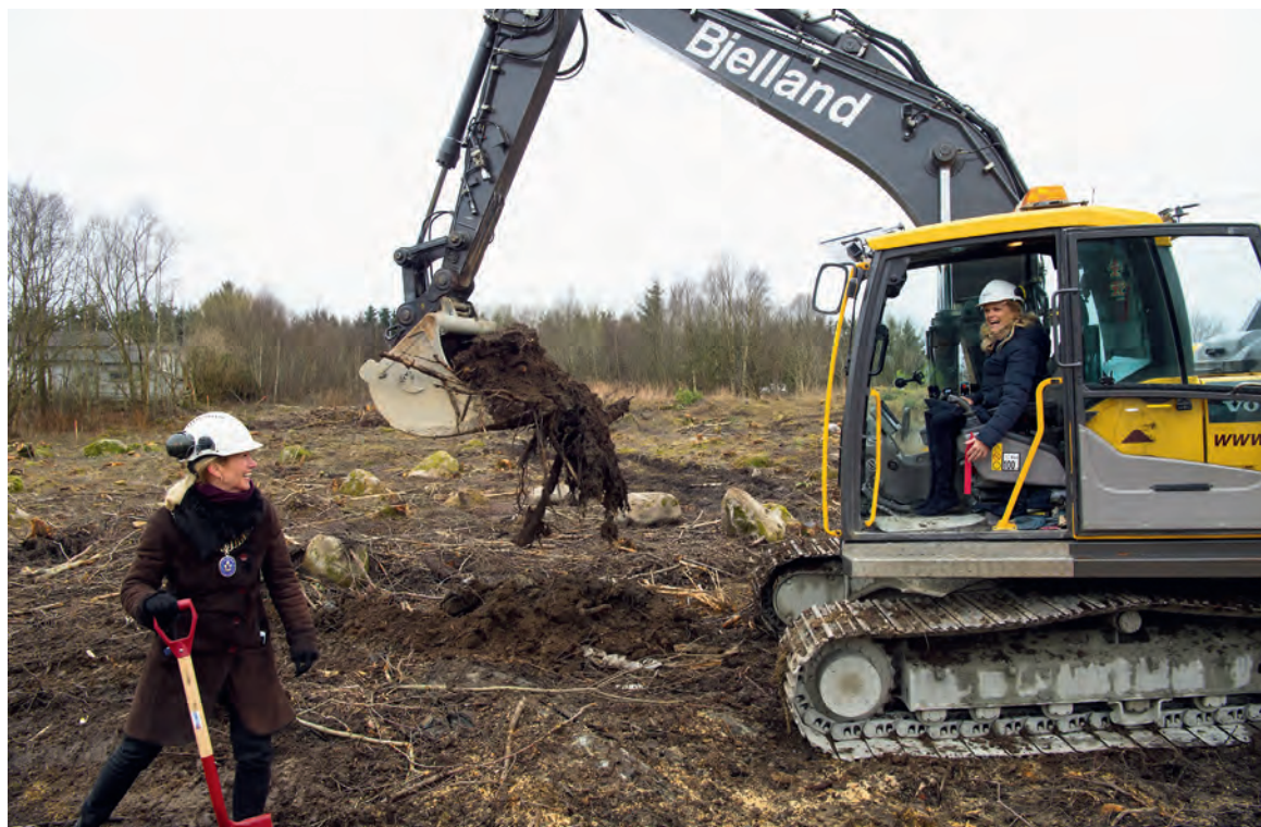
Ordfører Christine Sagen Helgø og statssekretær i Olje- og energidepartementet, Ingvild Smines Tybring-Gjedde sørget for å ta første spade- og gravemaskinstikk for Oljemuseets nye museumsmagasin 23. mars 2018. Foto: Shadé B. Martins/Norsk Oljemuseum
