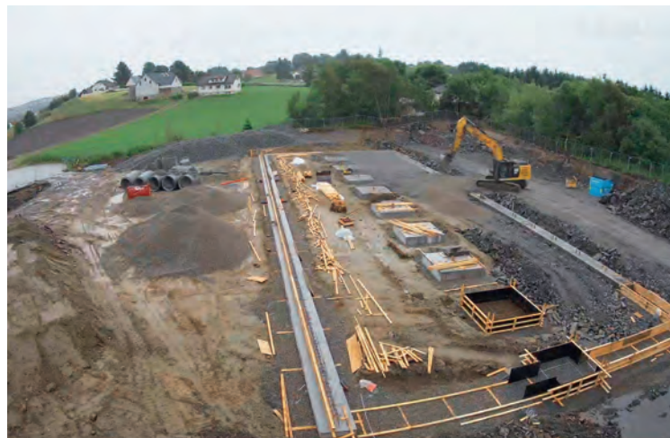
20. juni, 2018: Fundamentene til magasindelen er støpt. Fylling av bærelagsmasser til gulvet pågår. Foto fra byggekamera
