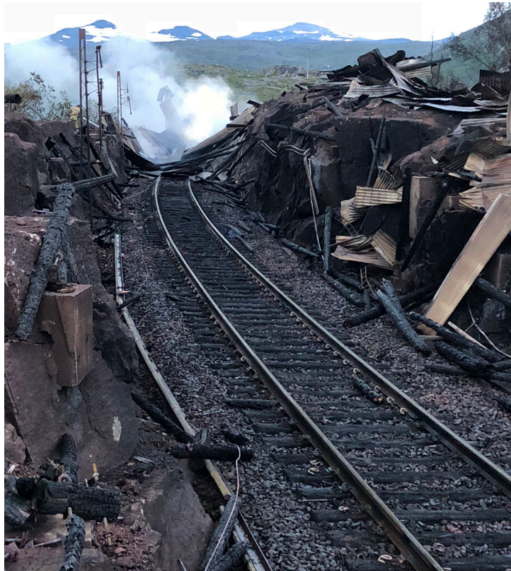
Skader på Ofotbanen. Foto: Bane NOR SF
