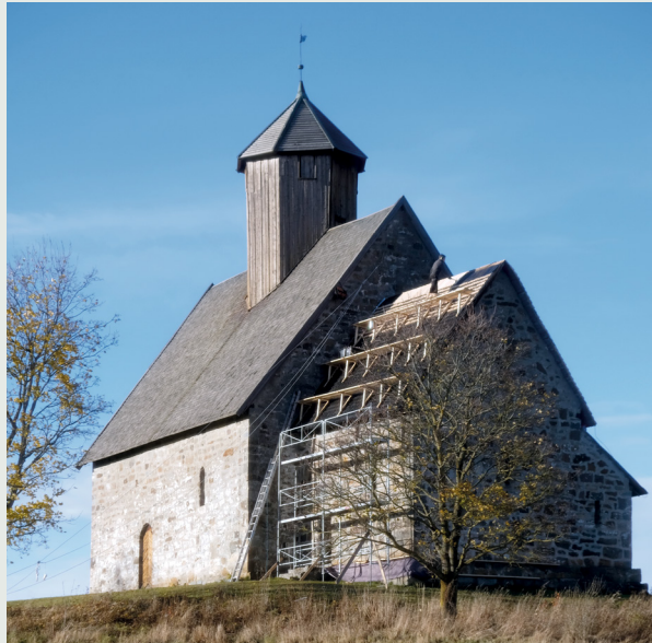
← Tingelstad gamle kyrkje St. Petri, Gran kommune, Innlandet. Kyrkja er oppført på 1200-talet. Tilskotet gjekk til istandsetting av tak. Både kortaket og taket over sakristiet vart tekt med ny spon og tjørebreidd. Foto: Morten Stige
