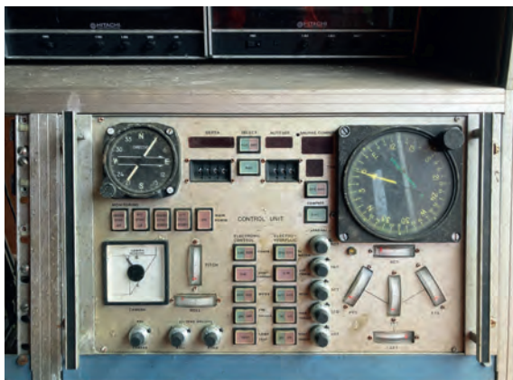
Innebygd kontrollutstyr før behandling. Utstyret var skittent, og det var mugg på alle overflater. Foto: Kirsten T. Hetland/Norsk Oljemuseum
