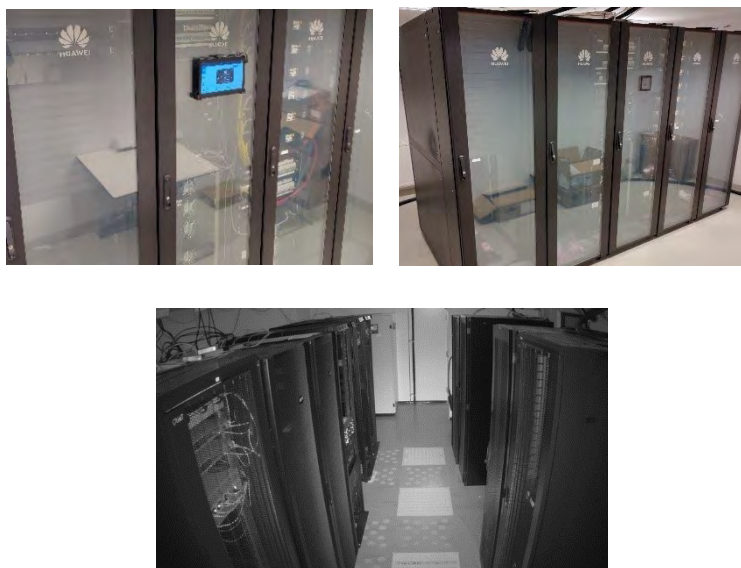
Bildene viser sekundært datarom med styrepanel.
