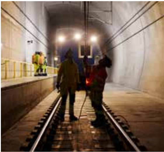
Arbeid i Blixttunnelen på Follobanen. Tunnelen har et løp i hver retning og er med 19,5 kilometer Nordens lengste jernbanetunnel.
