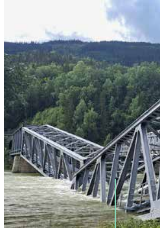
Under ekstremværet «Hans» i august kollapset Randklev bru på grunn av flommen Gudbrandsdalslågen. I oktober ble broelementene til broen hevet opp igjen fra elven. Broelementene var i god nok stand til å gjenbrukes, og broen gjenåpner til sommeren 2024.
