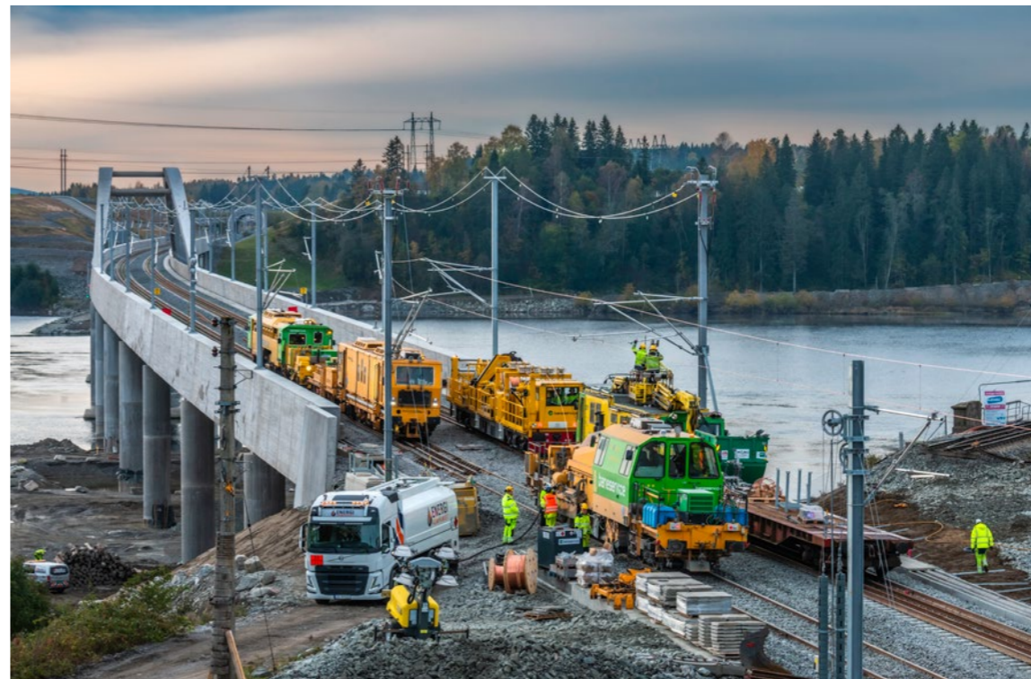
Den 836 meter lange Minnevikabruen var ferdig støpt i juli 2022, og i 2023 ble de jernbanetekniske anleggene bygd ferdig.
